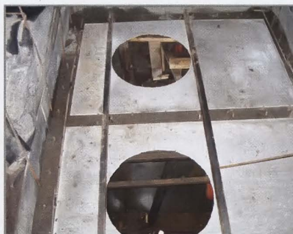
Опалубка перекрытия также выполнена из асбоцементных плит. В местах установки колец горловины в них заранее делают отверстия.
