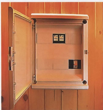
В таком щитке монтируют комплект системы GSM-контроля.
