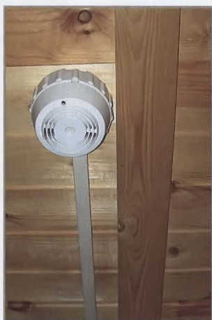
Пожарные датчики установлены на потолке в том месте помещения, где высока вероятность скопления дыма.
