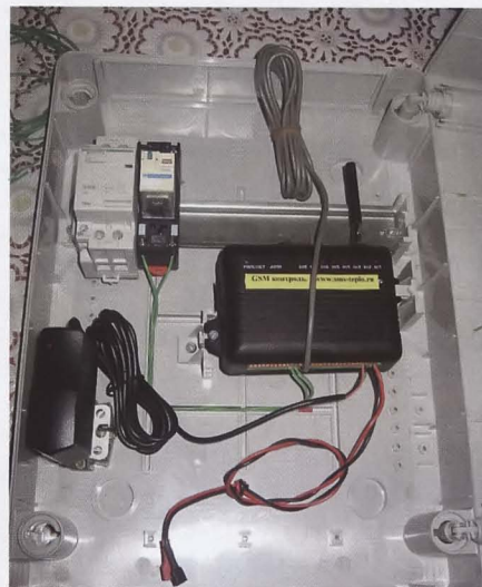
GSM-контроллер, контакторы и блок питания установлены в монтажный бокс.
