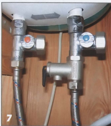
Трёхпроходные краны облегчают слив воды из электрического водонагревателя при подготовке к зиме.
