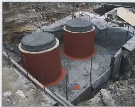
Спустя несколько дней после бетонирования перекрытия септик сверху гидроизолируют и засыпают грунтом. На кольца горловины устанавливают колодезные люки.
