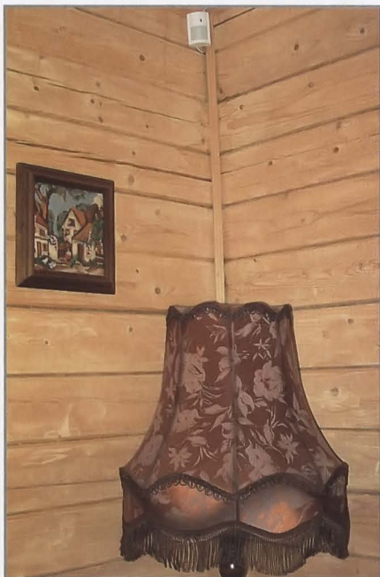
Датчики движения установлены под потолком, что исключает образование непросматриваемых «мертвых» зон в помещении.
