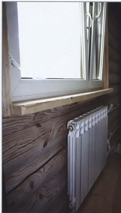
Радиатор под окном комнаты на первом этаже.
