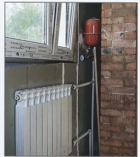
Радиатор спальни второго этажа. За трубой расположен расширительный бачок.
