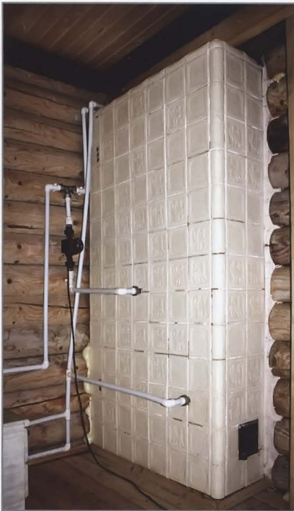
Часть печи, выходящая в комнату.
