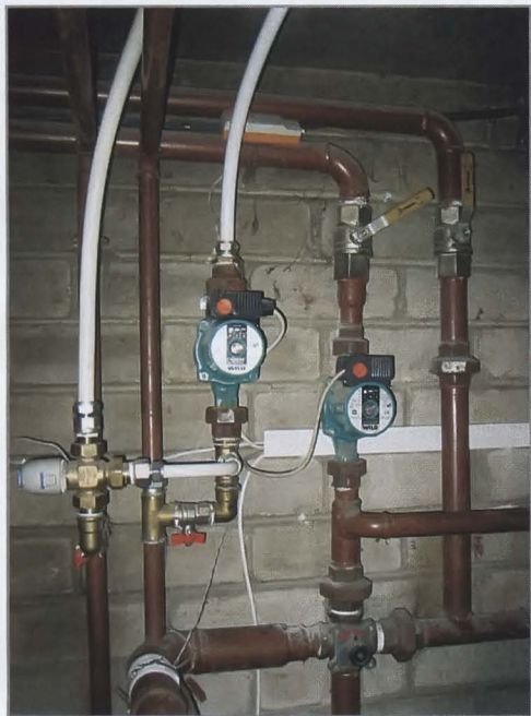
Разводка трубопроводов и циркуляционные насосы радиаторов и бойлера.
