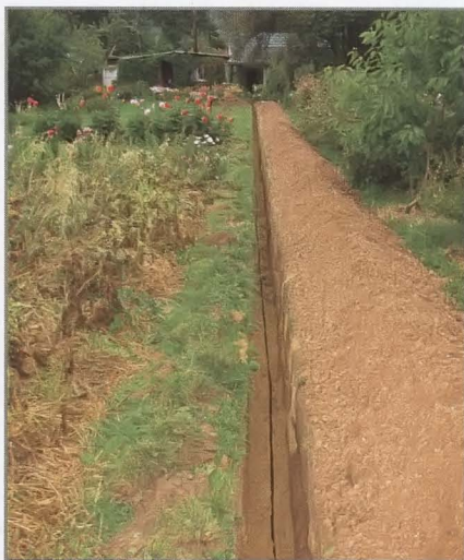
Траншею для укладки кабеля под землёй копают на глубину 0,7 м. На её дно насыпают песок слоем 10 см.
